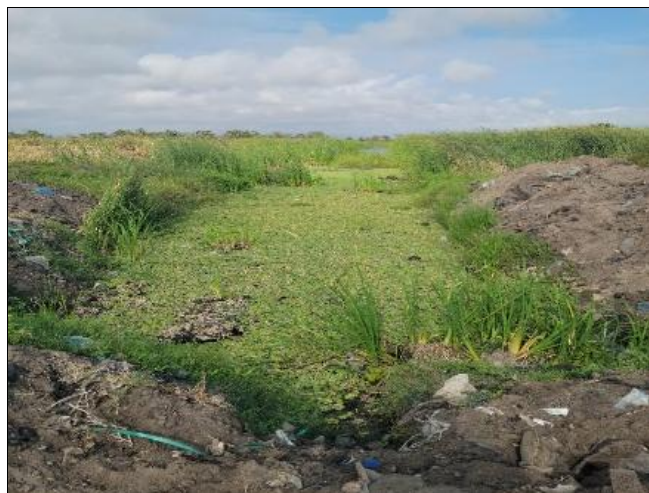
Photo 4: Envasement d'ouvrage de drainage lié à une mauvaise exploitation
